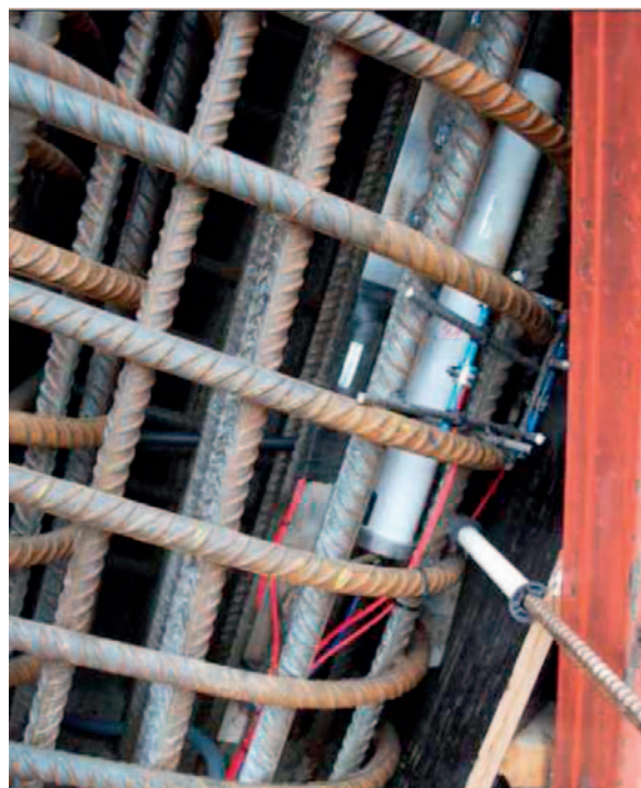
Fot. 2. Widok zamontowanego czujnika do pomiaru „naprężeń” w betonie bezpośrednio przed betonowaniem elementu. W głębi widoczne strunowe czujniki do pomiaru odkształceń betonu
